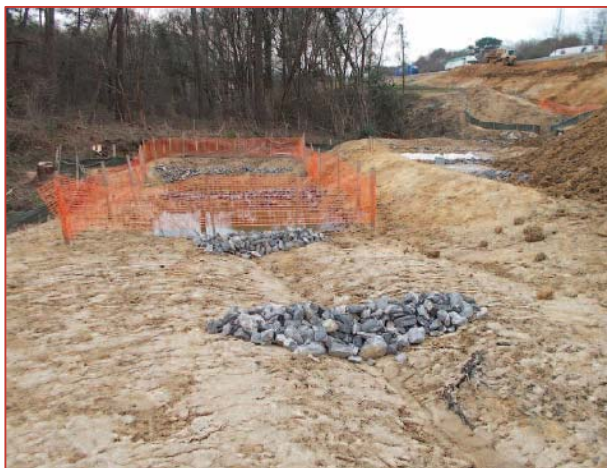
↑ Noue équipée de seuils en granulats concassés
